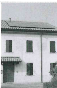
Impianto fotovoltaico 5,16 kWp Guastalla - RE
